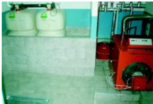
Nowoczesna, ekologiczna, olejowa kotłownia w budynku Biblioteki Publicznej. fot. Kruszewski
