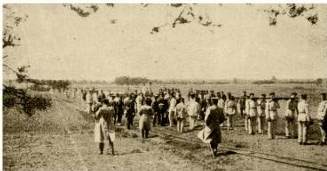
Budowa kolejki polowej na trasie Przasnysz – Młodzianowo; „jasne” mundury żołnierzy to drelichowe ubrania robocze. Grupa po prawej stronie trzyma na ramionach gotowe do ułożenia przęsło torowiska.
