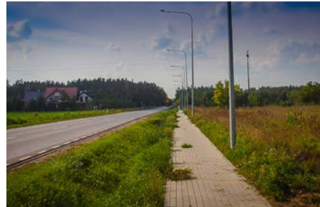
Budowa chodnika i oświetlenia przy ul. Poniatowskiego. Koszt budowy - 370 000,00 zł; oświetlenia 151 928,16 zł.
